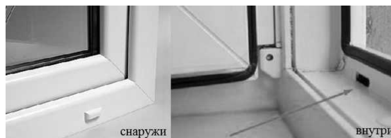
Рис.6. Дренажное отверстие снаружи (слева) и внутри (справа)
